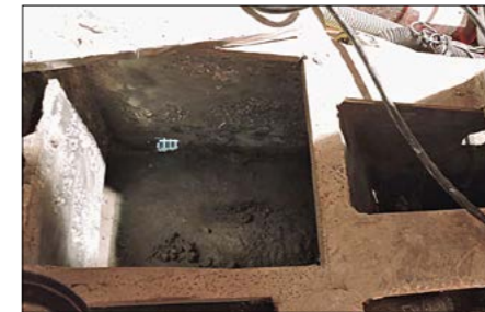
▲ Les compartiments du haut de quille sont propres, on est prêt pour attaquer la soudure.
