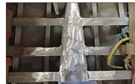
▲ Tout est soudé et parfaitement étanche à nouveau. Reste à tout remonter!
