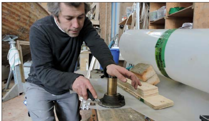
▲ Avant de poser les différents winches, il est nécessaire de préparer les plaques isolantes en les découpant au bon diamètre.
