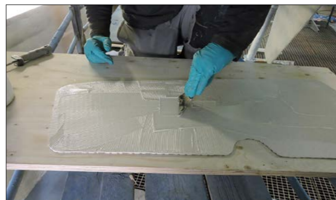
▲ On applique la colle époxy avec une spatule pour empêcher que des paquets de colle ne se forment au moment du marouflage.
