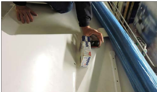
▲ Il est indispensable de simuler la disposition du nouvel accastillage avant de se lancer dans le gros des travaux.
