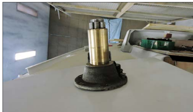
▲ Une fois vissé et boulonné, le winch de piano bâbord, sans sa poupée, prend place fièrement sur le pont tout neuf de Diaphani.
