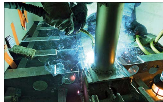
▲ Il n'y a pas de refit sans mauvaise surprise. L'électrolyse dans la quille a stoppé pour deux longs mois la poursuite des travaux. (VM n°247).
